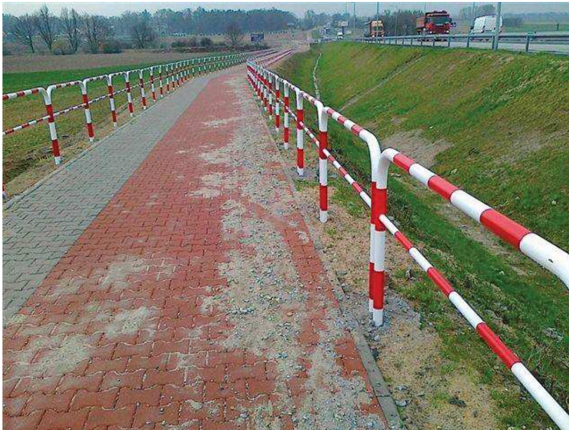
Ilustracja 6. Przykład nieprawidłowego zastosowania nawierzchni i bariery na trasie pieszo- rowerowej
